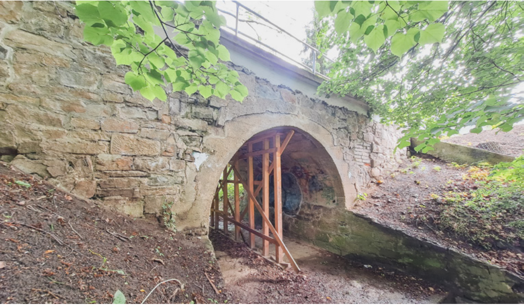
Most na ulici Jasénky je ve špatném stavu. Foto: archiv města
